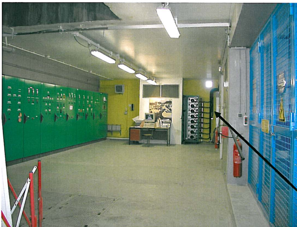
LOCAL TGBT SALLE DE CONTROLE
